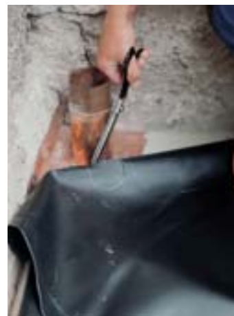
8. Burlanul de scurgere trece prin pardoseală printr-o țevă din cupru care e izolată cu pânză cauciucată.
