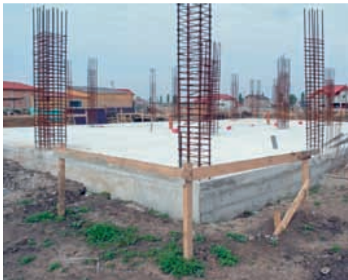
În cazul de față armătura metalică este expusă la procesul de coroziune, fapt pentru care turnarea betonului nu trebuie să întârzie prea mult.
