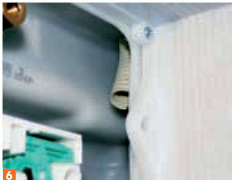
6 Soluție subtilă pentru evacuarea apei de condens: tuburile flexibile ajung în rezervorul toaletei, fiind astfel redus consumul de apă necesar curățării ei.
