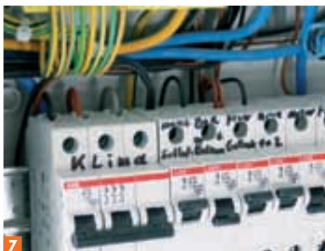
7 Instalația de aer condiționat are siguranțe separate în tabloul electric. În afara perioadelor de utilizare, ea poate fi decuplată de la alimentarea cu energie.
